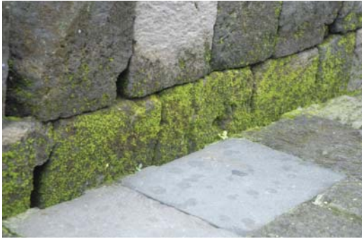
Gambar 2. Blok batu yang ditumbuhi lumut
