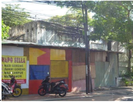
b. Gambar 7. (a, b) Rumah di ujung Jalan Embong Ploso atau di sepanjang ruas Jalan Kayun, dengan kondisi rusak tanpa atap. (Sumber: koleksi foto pribadi)
