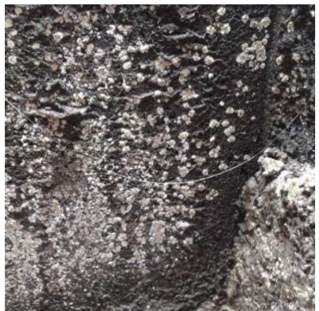
Foto 1. Tampak kerak yang diduga merupakan mikroorganisme di sisi batuan penutup drainase Candi Borobudur pada sisi selatan lantai II bidang H.
